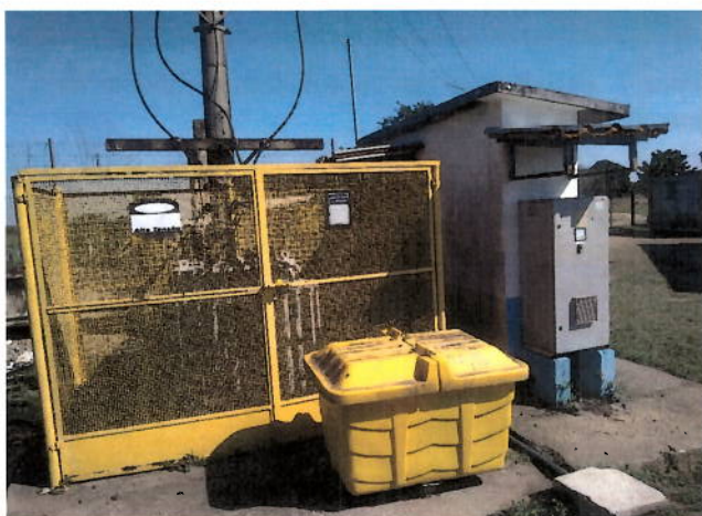
Foto 9: Transformador em área isolada em boas condições de manutenção .
