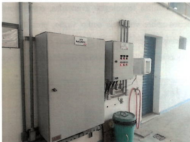
Foto 49: painéis elétricos da EEAT.
