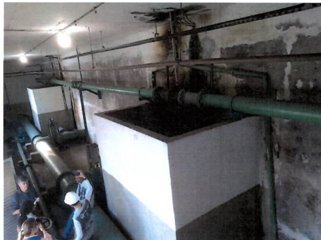
Foto 35: galeria de filtros necessitando de obras (parte inferior).
