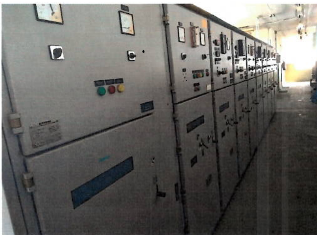
Foto 16: Painéis elétricos dos grupos motobombas.
