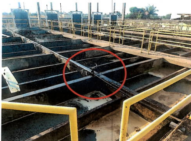
Foto 23: Floculador com aspersor de água para diminuir a formação de “espuma” orgânica.
