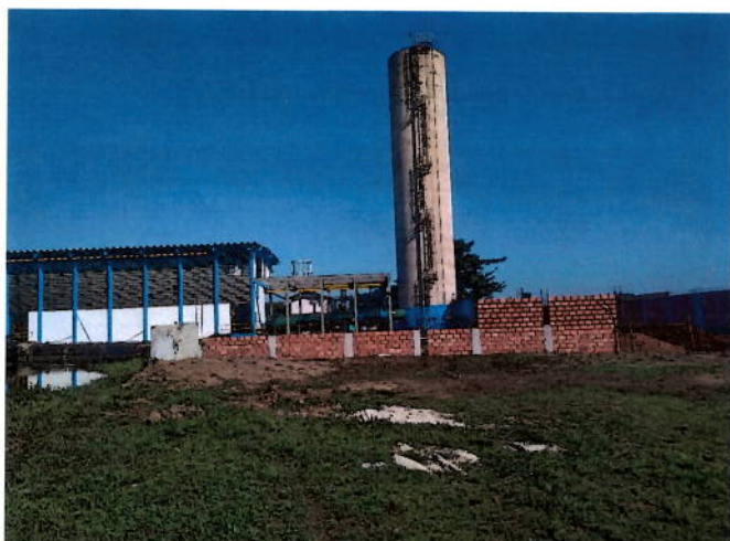
Foto 11: Estação elevatória de água bruta.
