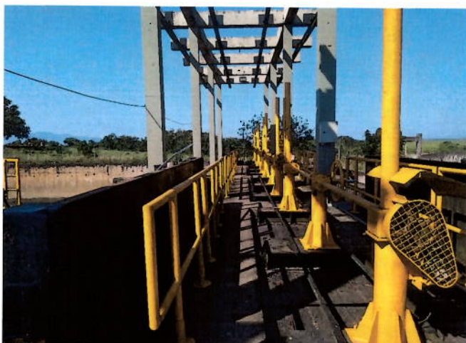
Foto 3: Sistema de acionamento do gradeamento em boas condições de manutenção .
