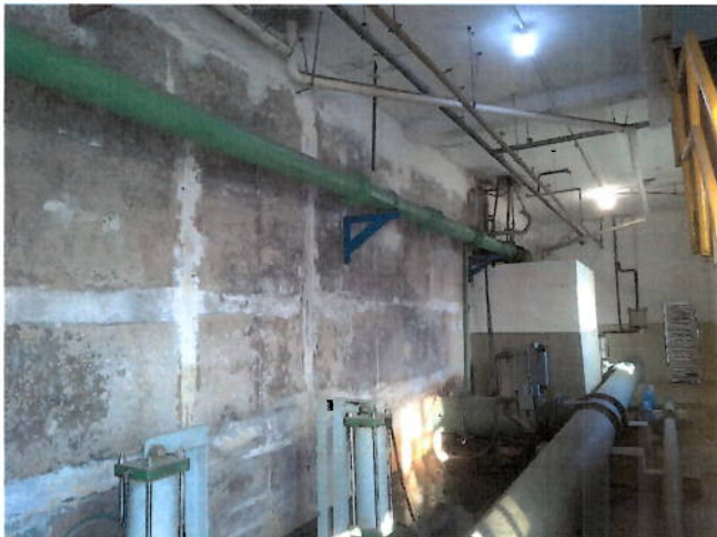
Foto 34: galeria de filtros necessitando de obras (parte inferior).
