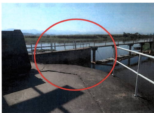
Foto 8: trecho com ausência de guarda-corpo.
