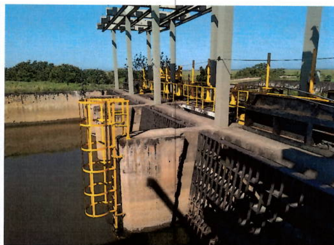
Foto 4: Escada com gaiola em boas condições de manutenção .
