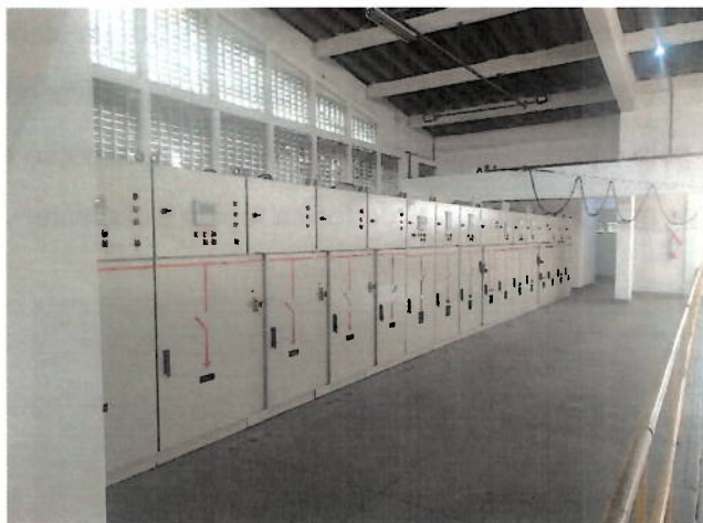
Foto 48: painéis elétricos da EEAT.
