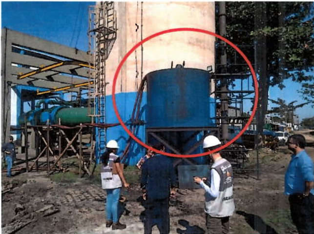
Foto 14: sistema de adição de carvão ativado.
