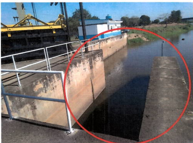
Foto 7: trecho com ausência de guarda-corpo.
