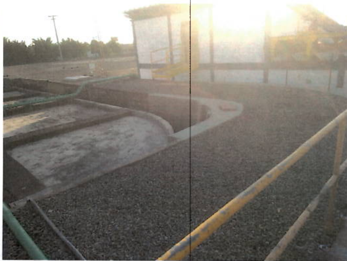
Foto 39: Parte superior do tanque de contato.
