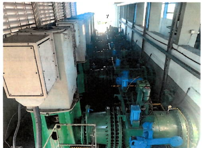
Foto 15: conjuntos motobombas da EEAB.
