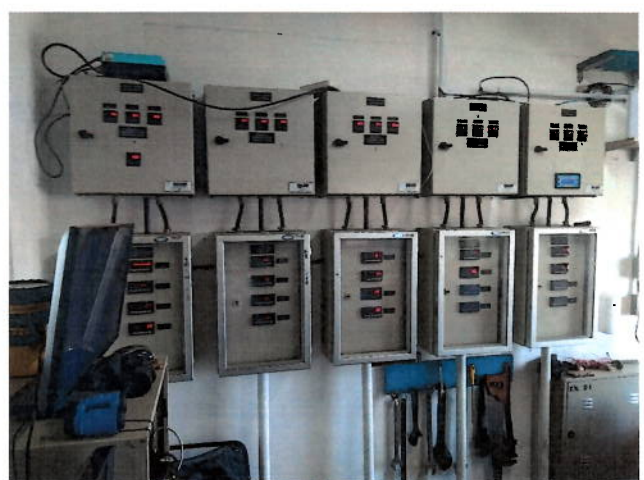
Foto 17: Painéis elétricos dos grupos motobombas.
