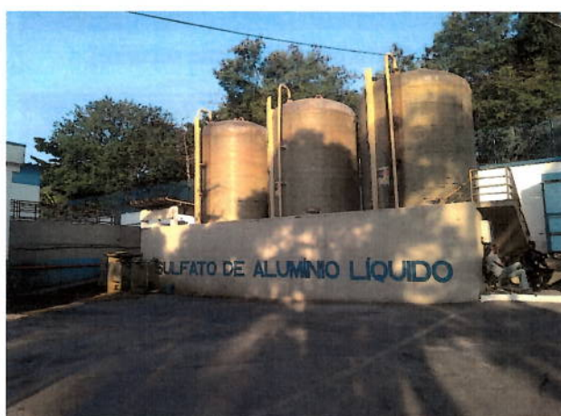
Foto 37: Tanque de sulfato de alumínio.
