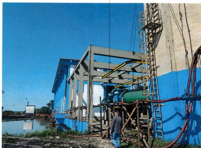
Foto 13: Estação elevatória de água bruta.
