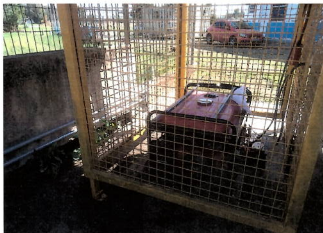
Foto 10: Gerador de energia elétrica.
